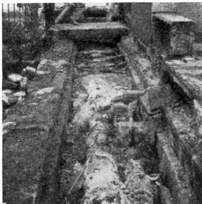
Abb. 42. Alte Thermalwasserleitung, mit Steinplatten überdeckt. Die Leitung war defekt, so daß die Dämpfe austreten konnten. Infolgedessen sind die Leitungen außen und die Steinplatten an der Unterseite dick mit den Mineralbestandteilen des Thermalwassers überkrustet
